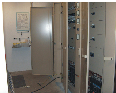
QGBT – Quadro Geral de Baixa Tensão
